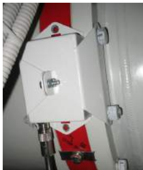
Рис. 2.4.1.2. Датчик марки «AES» смонтированный на стыке корпусов КРУЭ.
